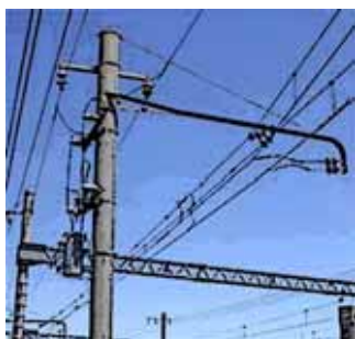
【電車トリー線】 ・高さ測定 ・3次元位置測定
