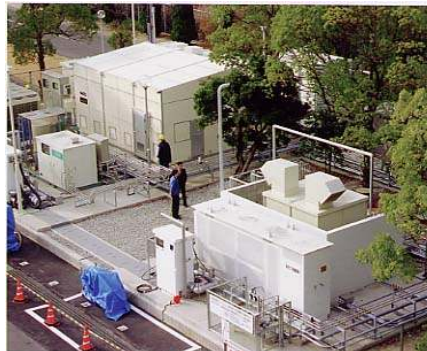
水素貯蔵・供給ステーション
