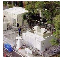
水素供給 ステーション
